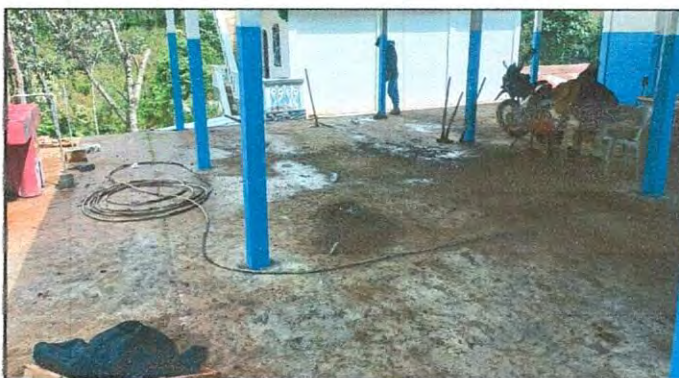
Foto 4: Susticion de plancha de concreto de patio
